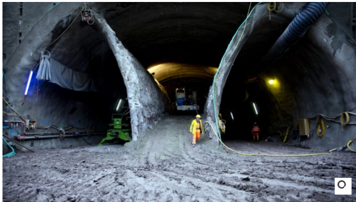
Seit 2013 laufen die Arbeiten am Cannstatter Tunnel für den neuen Stuttgarter Tiefbahnhof. Das Foto zeigt die Arbeiten im Jahr 2016. (Foto: Johannes Simon)
